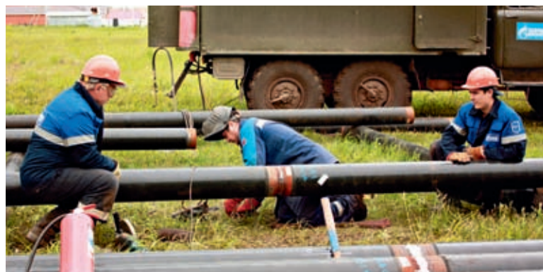
Сегодня в каждом регионе разворачиваются плановые работы по подготовке газового хозяйства к зиме.
