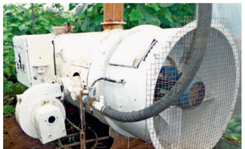
Газовое оборудование с работающей автоматикой.
