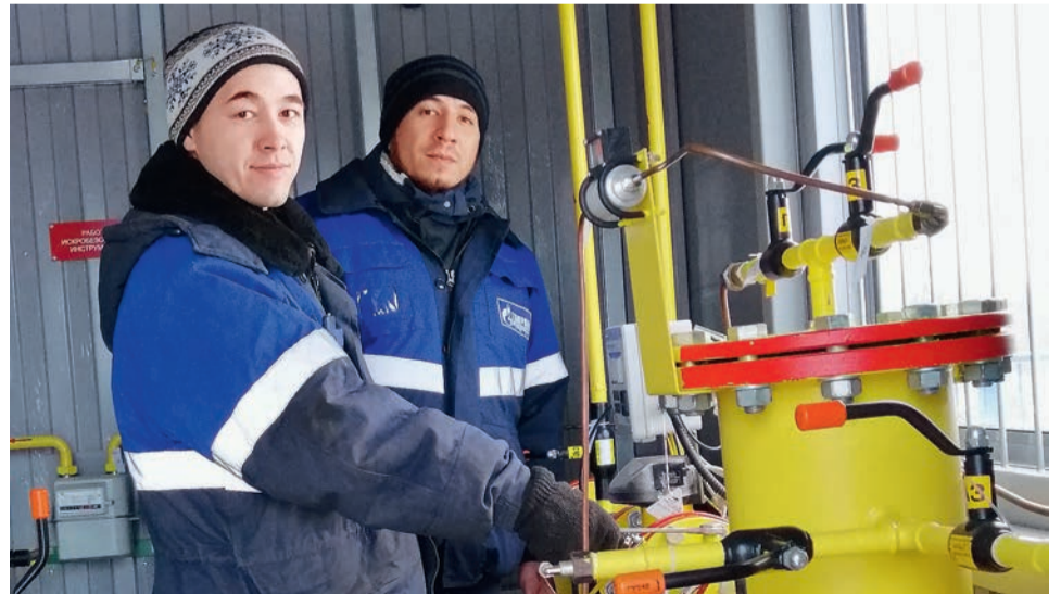
Слесарь ЭРПГ СГС Артур Ярмухаметов и мастер СГС Вагиз Исхаков проверяют работу оборудования головного ГРПБ на закольцовочном газопроводе города Нефтекамска.
